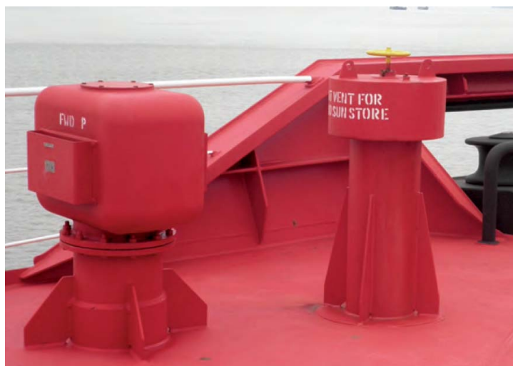
Rys. 6. Przykład wentylatora na pokładzie statku jako elementu narażonego na uszkodzenia i podlegającego sprawdzeniu w czasie inspekcji wolnej burty [8].
